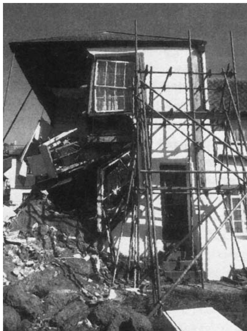
Дом из самана разрушается в Девоне, что вероятно вызвано штукатуркой на основе цемента.
